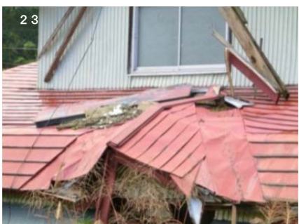
著しい変形と樋などの破損
