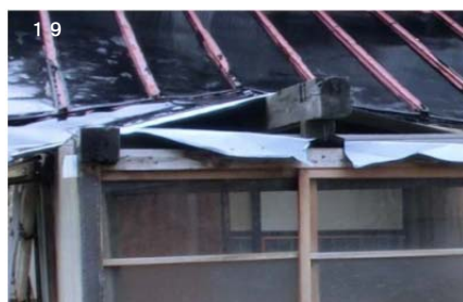
構造部材の大規模な損傷
