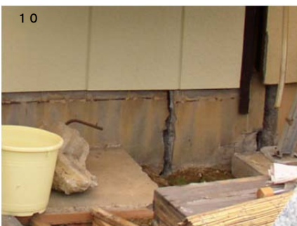
基礎に著しいひび割れ
