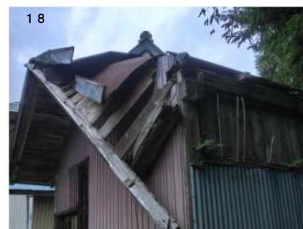
構造部材の大規模な損傷
