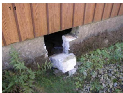
基礎に大規模な欠損
