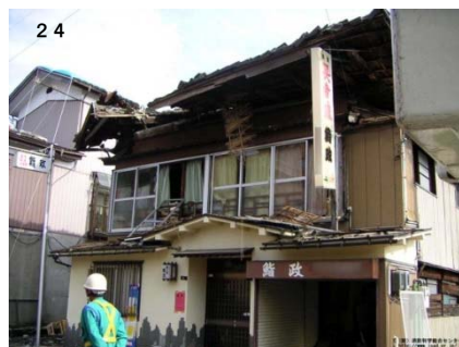
屋根が著しく破損している
