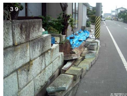
既に倒壊している (25 点)
