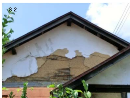
32 著しい劣化による壁下地の露出
