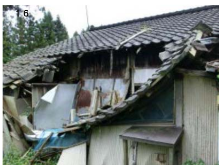
構造部材の大規模な損傷
