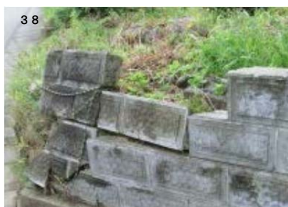
既に倒壊している (25 点)
