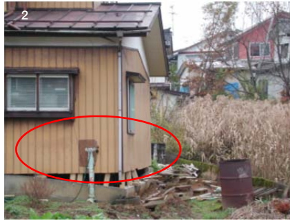
2 局所的な基礎の不同沈下
