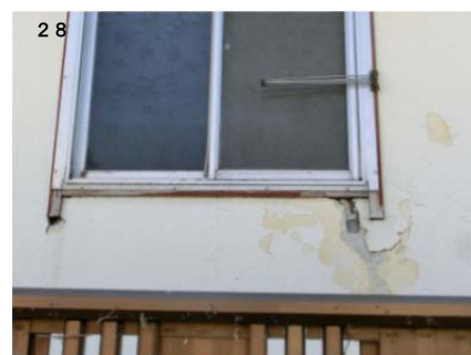
28 外壁にひび割れと剥離
