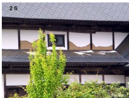
26 外壁仕上げの一部が剥落
