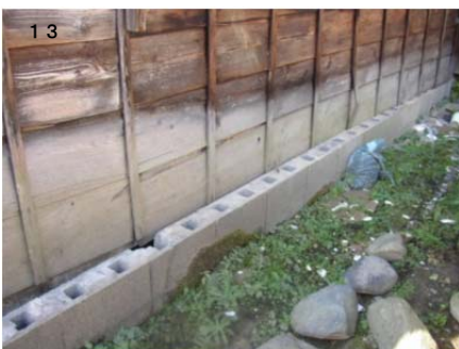
基礎と土台に大規模なずれ
