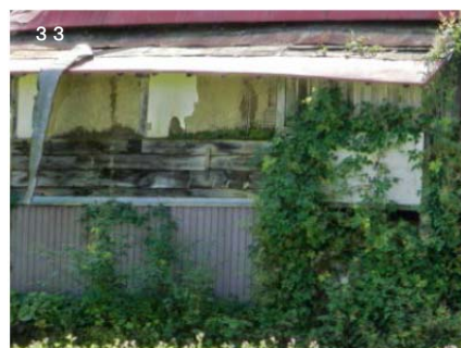
33 著しい劣化による壁剥落
