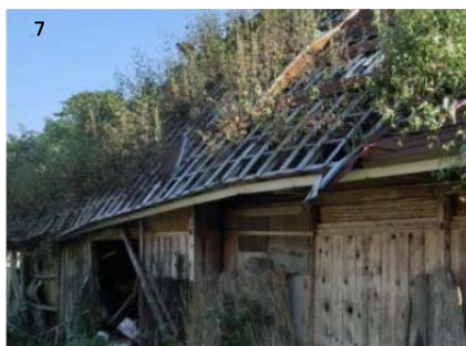
7 一見して倒壊のおそれがある
