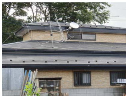
テレビアンテナの落下のおそれ
