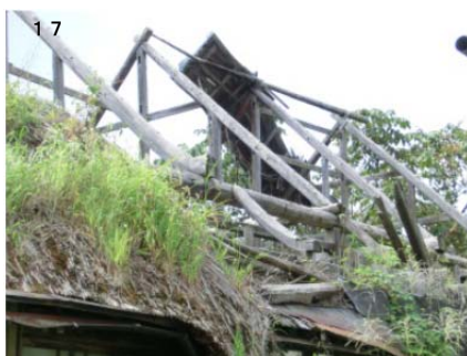
構造部材の大規模な損傷
