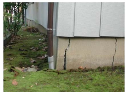
基礎の著しいひび割れ
