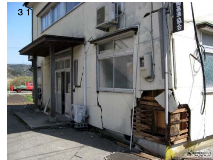
31 著しいひび割れ
