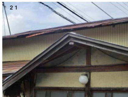
屋根ふき材の剥離
