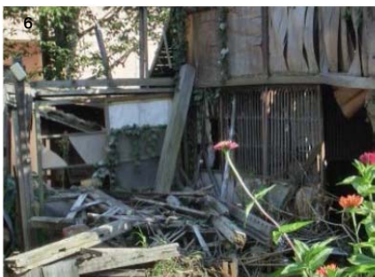
6 既に一部倒壊している
