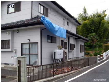
屋根ふき材の剥離
