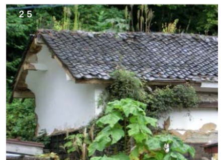
屋根の変形、樋や軒先の破損
