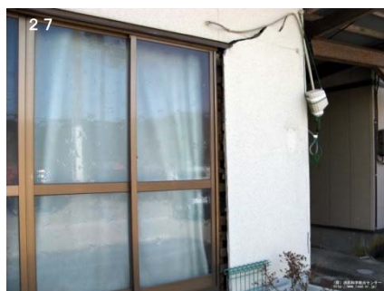
27 外壁にひび割れと剥離
