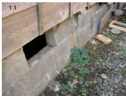
基礎に著しい損傷と傾斜
