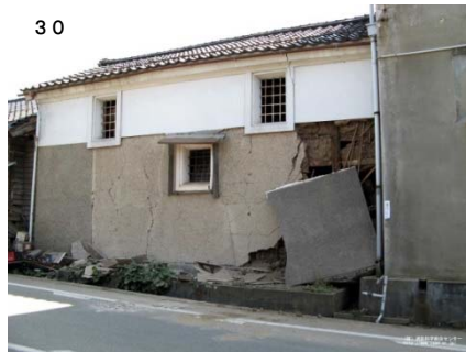
30 大規模なひび割れ及び剥落
