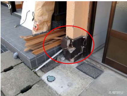
基礎の部分的な欠損
